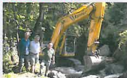
Aufräum- und Sanierungsarbeiten am Haidenbach - v.l. Josef Sappl, Günter Sonnleitner, Egon Dorfer
